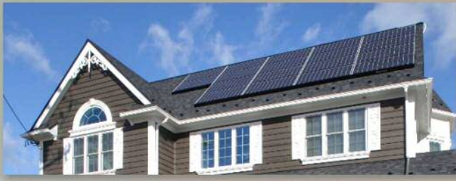
太陽光パネル 4.30kw
